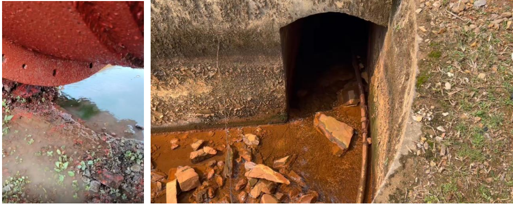
图 3.4 涵管出口渗漏现场照片
