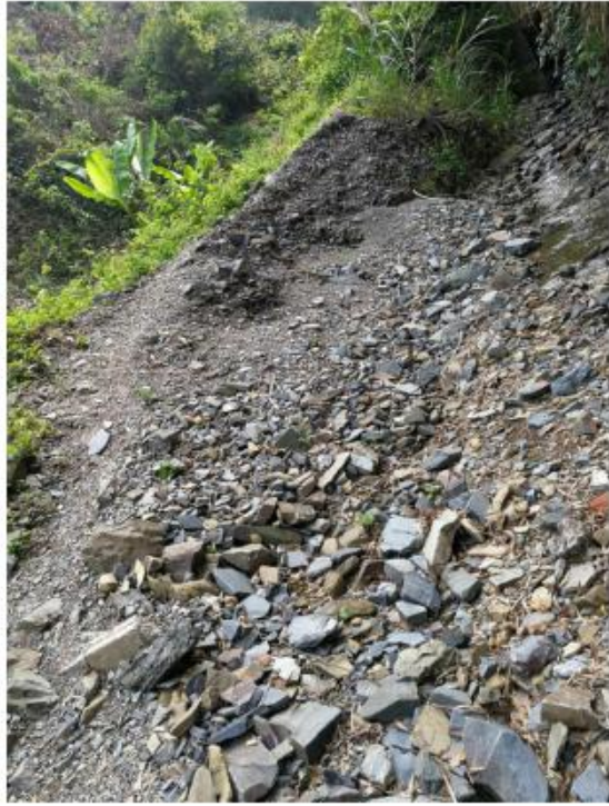
3#住庙组废渣 I 堆堆积现状
