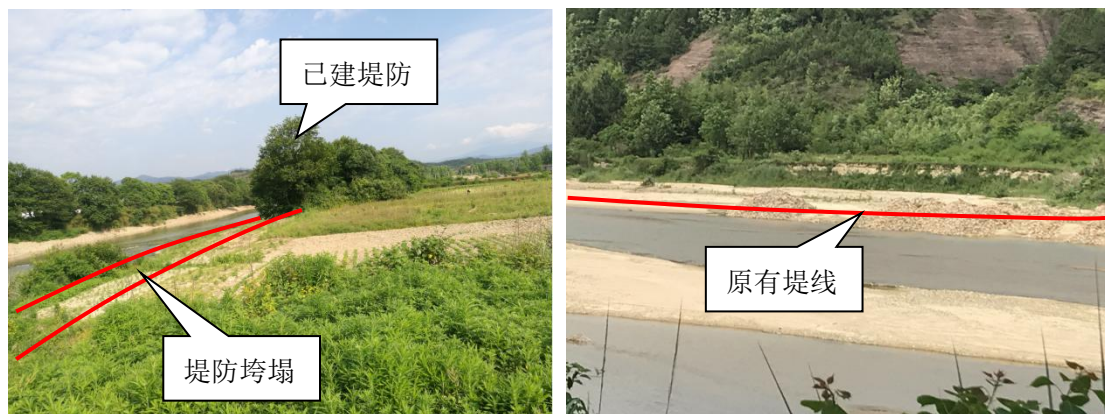
图 1-1 原有堤防垮塌现状示意图
